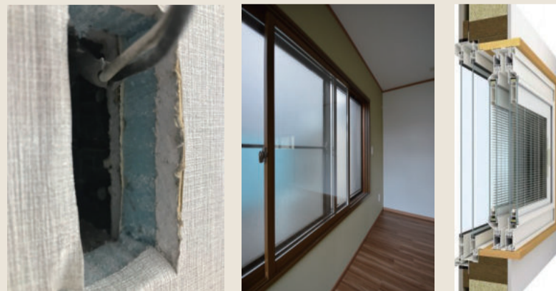
After: 壁の断熱材
