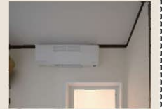
After：脱衣室のルームヒーター
